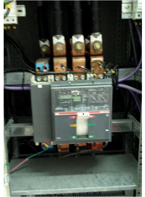
La foto de arriba muestra cómo vería un electricista o técnico de mantenimiento un tablero eléctrico.
